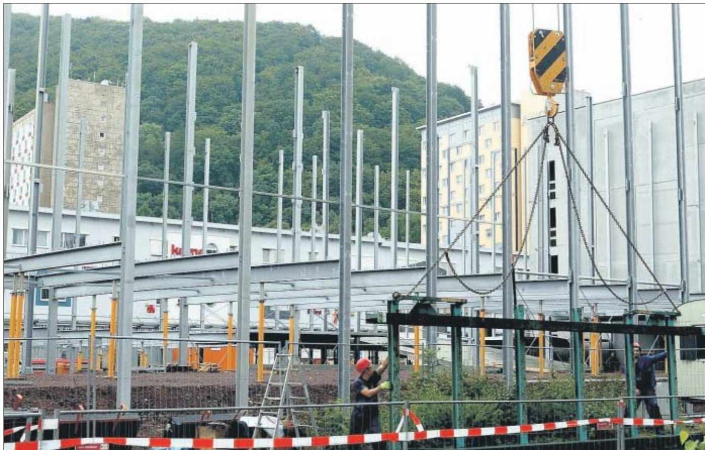
Dieser (Durch-)Blick auf den Domberg ist bald passé. Viele Suhler sind erschrocken über die Ausmaße des Parkhauses. FOTO: frankphoto.de
