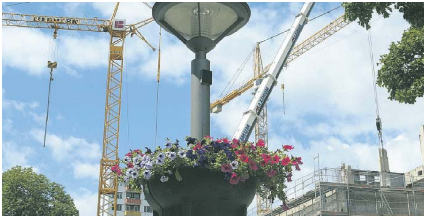
Mit einem Spezialkran müssen tonnenschwere Teile vom Kaufhof-Dach gehoben werden. FOTO: frankphoto.de
