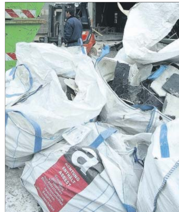
Nachdem ein Subunternehmer der Baustelle über Nacht den Rücken kehrte, herrscht Chaos: Unsachgemäß offen gelagerte Säcke mit Asbest riefen den Arbeitsschutz auf den Plan.
