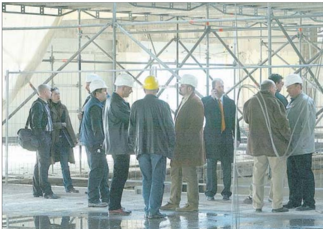
Mitglieder der städtischen Arbeitsgruppe informierten sich gestern über den Fortgang der Arbeiten im und am „Kaufhof“. Im Mittelpunkt stand die Gestaltung der Außenanlagen. FOTO: frankphoto.de
