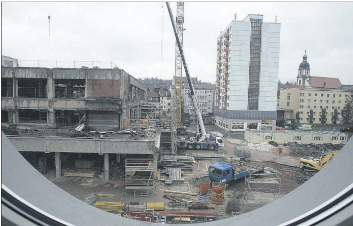
Rechts neben dem künftigen Shopping-Center wächst der Verbinder zum Parkhaus empord. Der Erdaushub fürs Parkhaus beginnt nächste Woche.
