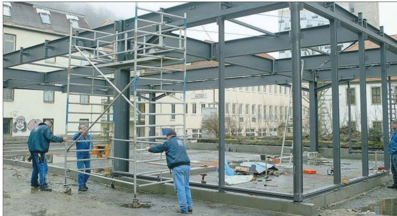
Gegenwärtig wird die Stahlkonstruktion für den Pavillon aufgebaut. Mitte März soll er fertig sein. FOTOS: frankphoto.de
