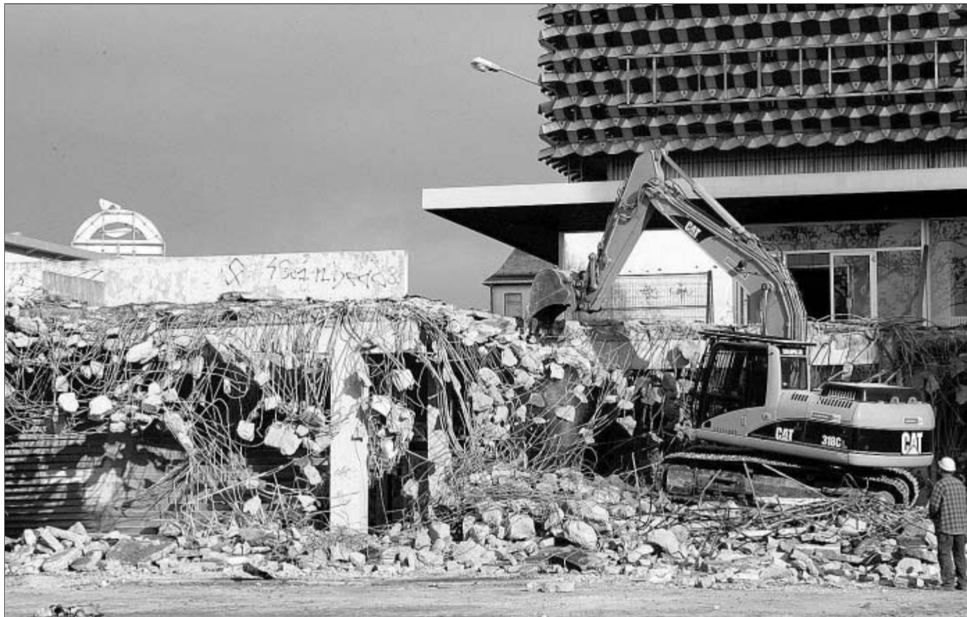
Die Wendeltreppe stemmt sich vehement gegen ihren Abriss. Hier wurde 1969 offenbar grundsolide gebaut. FOTO: frankphoto.de
